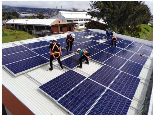
Figura 5. Vista de sistema fotovoltaico en Laboratorio de Sistemas Electrónicos para la Sostenibilidad
