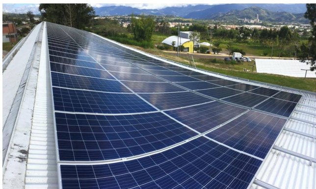
Figura 3. Vista sistema fotovoltaico sobre edificio de aulas
