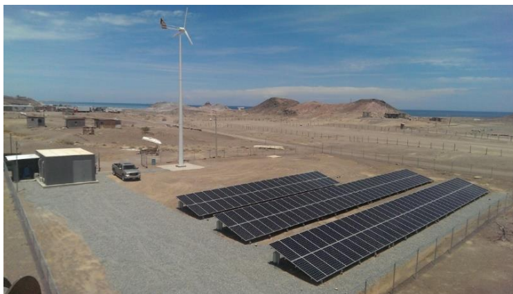
Fig. 5. Fotografía de la microrred de Puertecitos.
