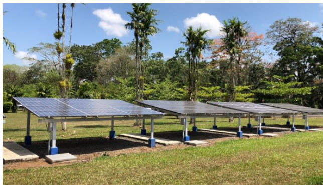
Figura 2. Vista sistema fotovoltaico de piso en San Carlos
