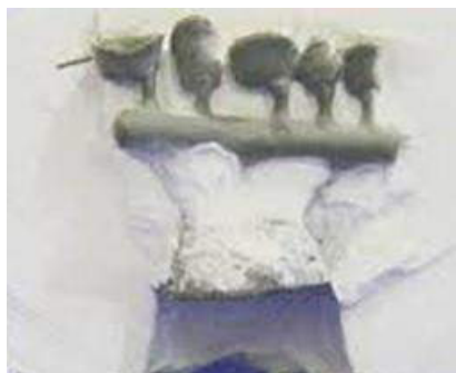
Ilustración 126. Estructura fundida, incrustada en el revestimiento.
