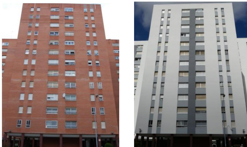
Fig. 7. Rehabilitación de las fachadas de los edificios. Antes y después de la intervención
