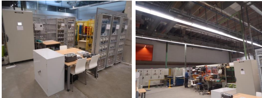
Figura 3. Imágenes de la red aislada y del despliegue de cableado.
