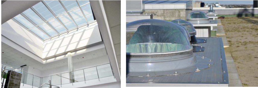
Fig 5.- a) Vista de uno de los lucernarios. b) Vista de los pozos de luz
